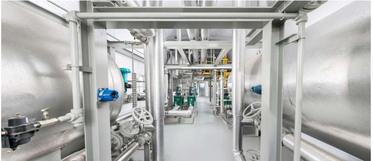
ASCO CO 2 -Rauchgas-Rückgewinnungsanlage (SGR)
